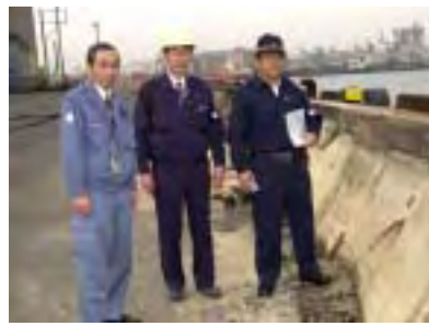
箱崎埠頭にて(1.2m 陥没)
